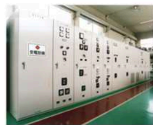
受配電盤・制御盤
