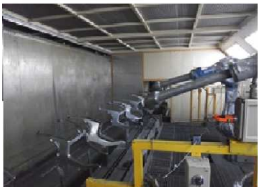
▲ 塗装ライン(フローコンベヤー)
