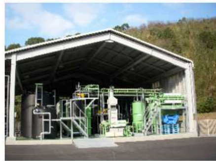
▲ 排水処理設備
